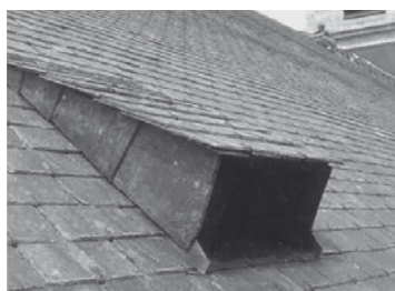
Figuur 2. Liggende chiroptière in een leiendak
